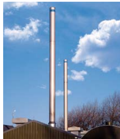
Enalco RVS schoorstenen
